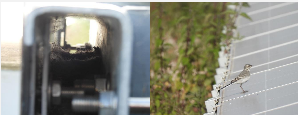
Links nest van een witte kwikstaart in de afgesloten buis van een transformatorhuisje. Rechts jonge uitgevlogen witte kwikstaart.
